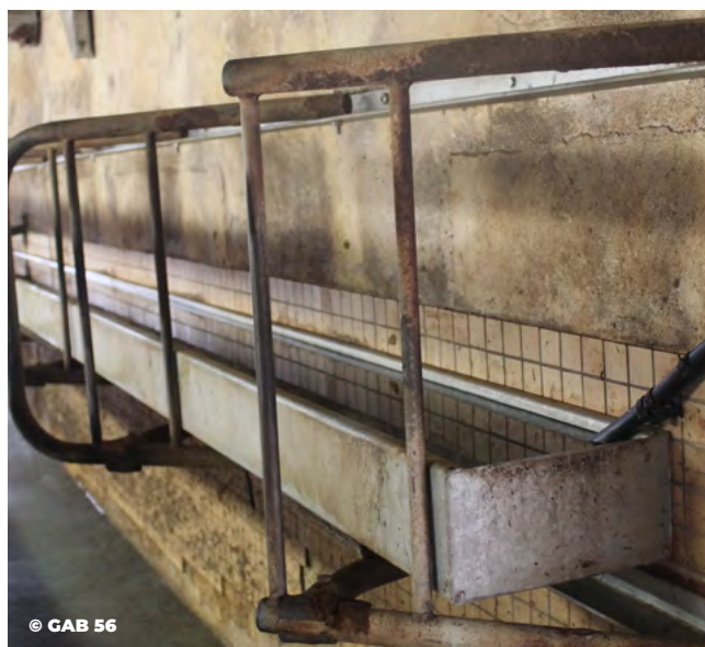
↑ Bac à eau installé en salle de traite
