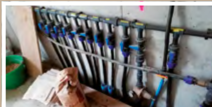
↑ Départ de ligne permettant d'isoler les différents réseaux et réparer plus rapidement en cas de besoin. Des compteurs peuvent être ajoutés
